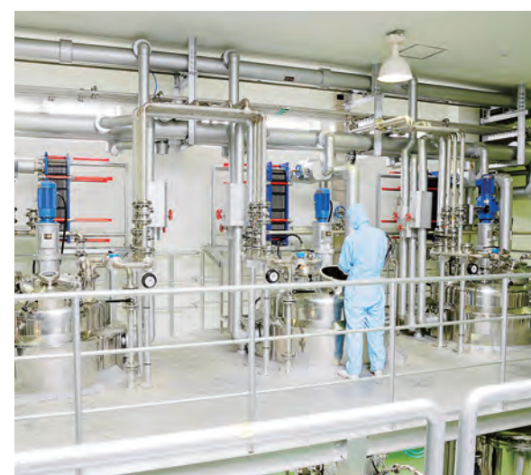
▲医薬品製造プラント
